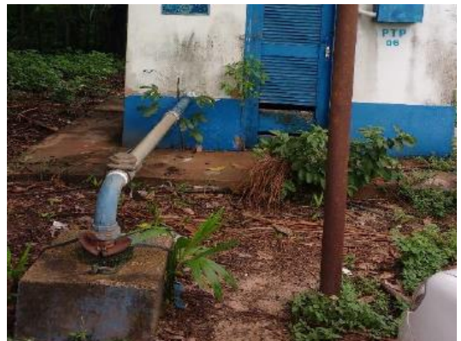
Figura14 – Poço loc. no Bairro Açaiçal
