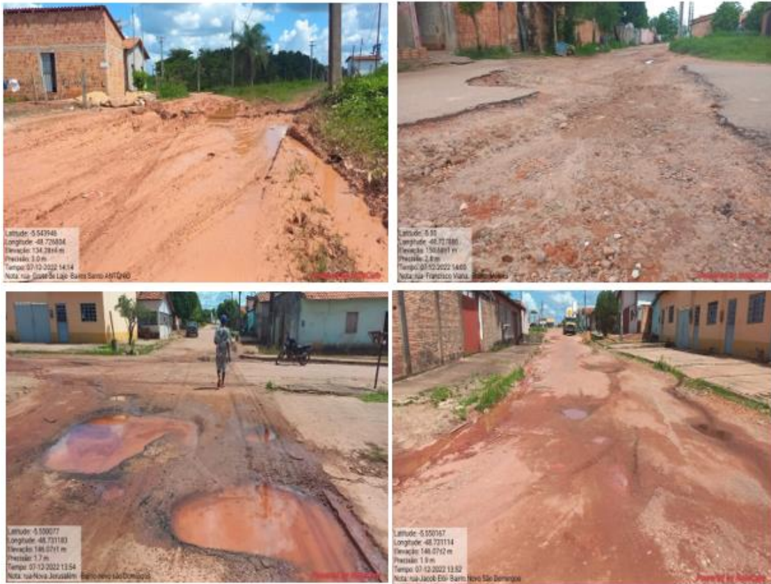
Figura 08 - Ruas necessitando de pavimentação
