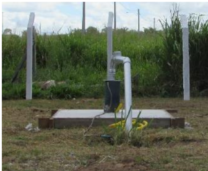
Figura 15 – Poço bombeia direto na rede de distribuição
